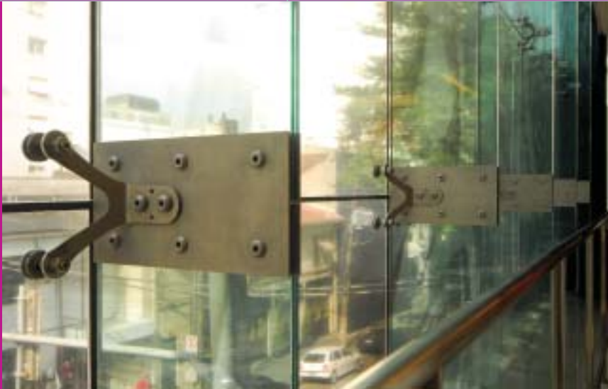
Ferragens tipo aranha: estruturas da Itamaracá compõem projeto
